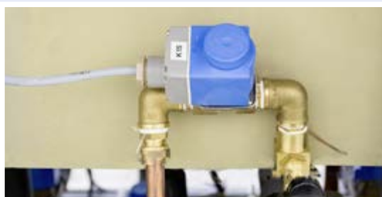
Aansturing van de kleppen. Een overloopbeveiliging is geïnstalleerd. Vooral bij het koelen wordt veel water in korte tijd toegevoegd.
