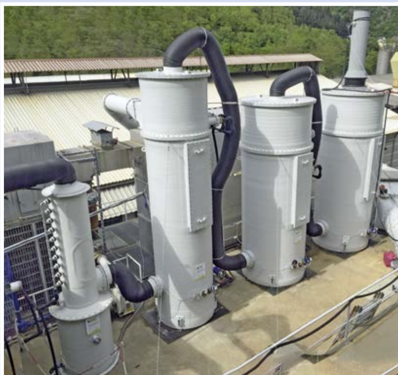
De complete installatie in één overzicht
